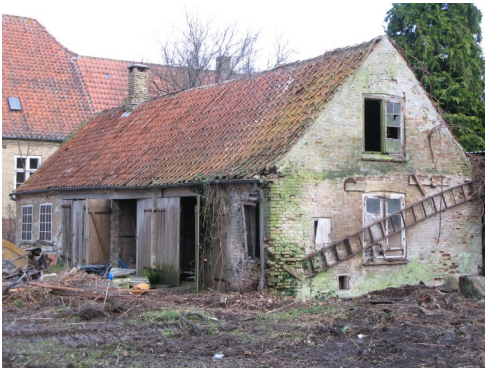
Udhuset var i dårlig stand og måtte nedrives
